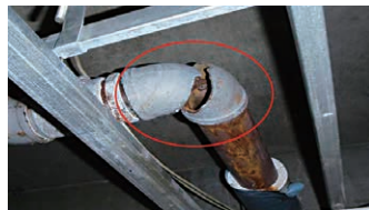
屋内給水管の破損
