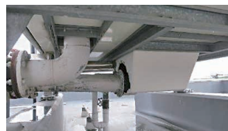
可とう継ぎ手が異状による機器と配管の接続部が破損
