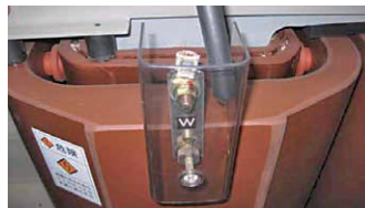
変圧器の揺れによる一次側圧着端子の破損
