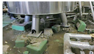
設備機器 (貯湯槽) 基礎の破損
