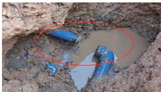
給水引込配管の破損
