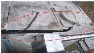
受水槽の破損
