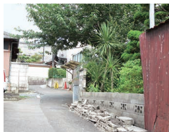
写真16 CB塀(被害あり)
