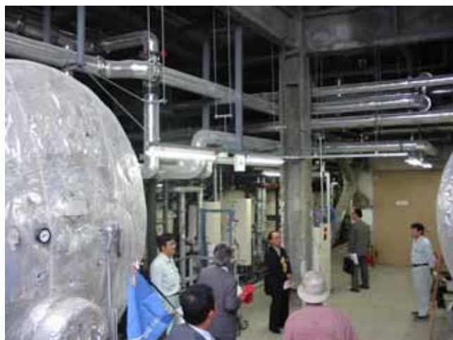
ボイラー室で給湯システムの説明を受ける見学者
